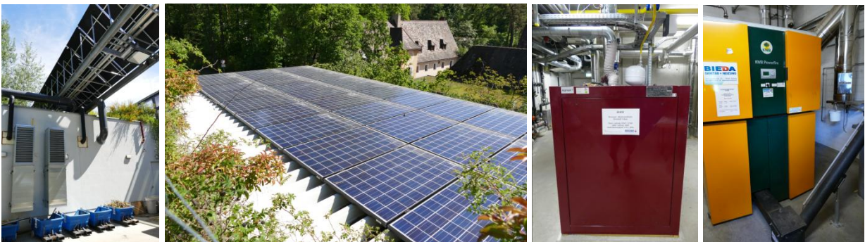
Solarthermie, Photovoltaik, BHKW und Hackschnitzelheizung im Tiergarten
